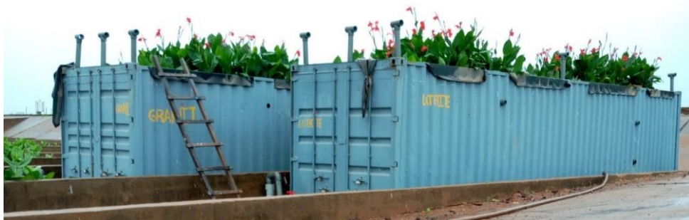
Photo 5 : Vue d'ensemble des filtres plantés de Canna generalis
