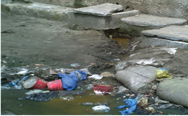
Photo 1 : Ecoulement des eaux vannes dans la rue au secteur Espoir de Koumassi-Campement
