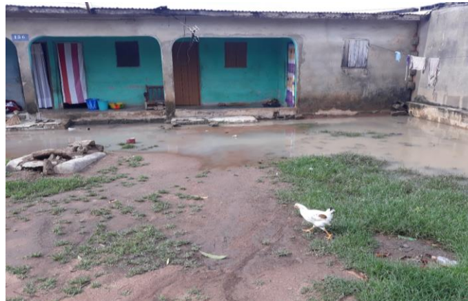
Photo 5 : logement ne respectant pas les normes de construction dans un état de délabrement avancé, Clichés : auteurs, juillet, 2018
